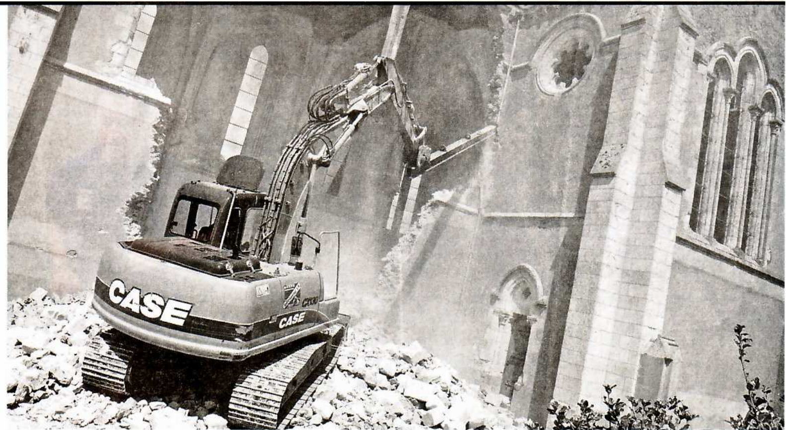
Victime d'un projet de réhabilitation trop coûteux, l'église de Saint-Georges-des-Gardes, dans le Maine-et-Loire, a été démolie en août dernier. Sipa.
